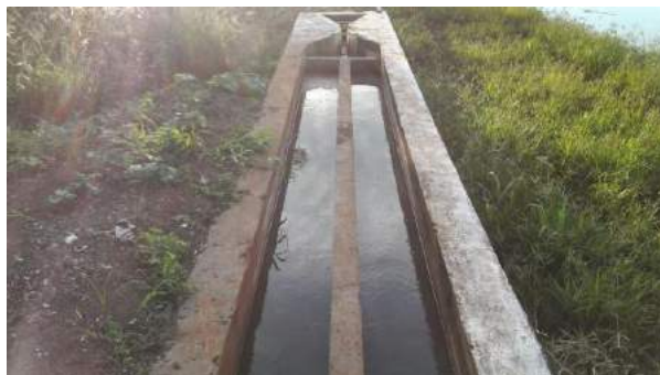
Calha Parshall e Caixa de Areia
