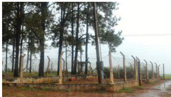
Estação elevatória AABB
