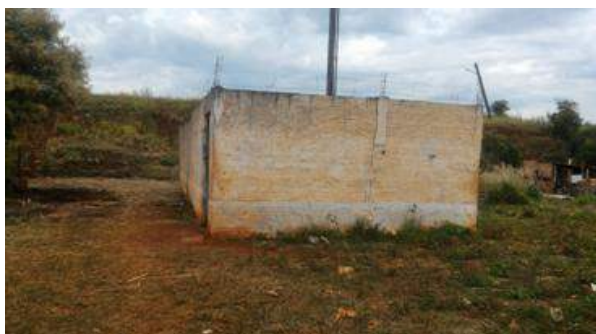
Casa da estação elevatória COHAB
